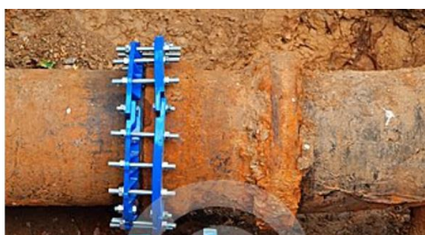
Bild 7. Yttre korrosion är vanligast på dricksvattenledningar [35].
